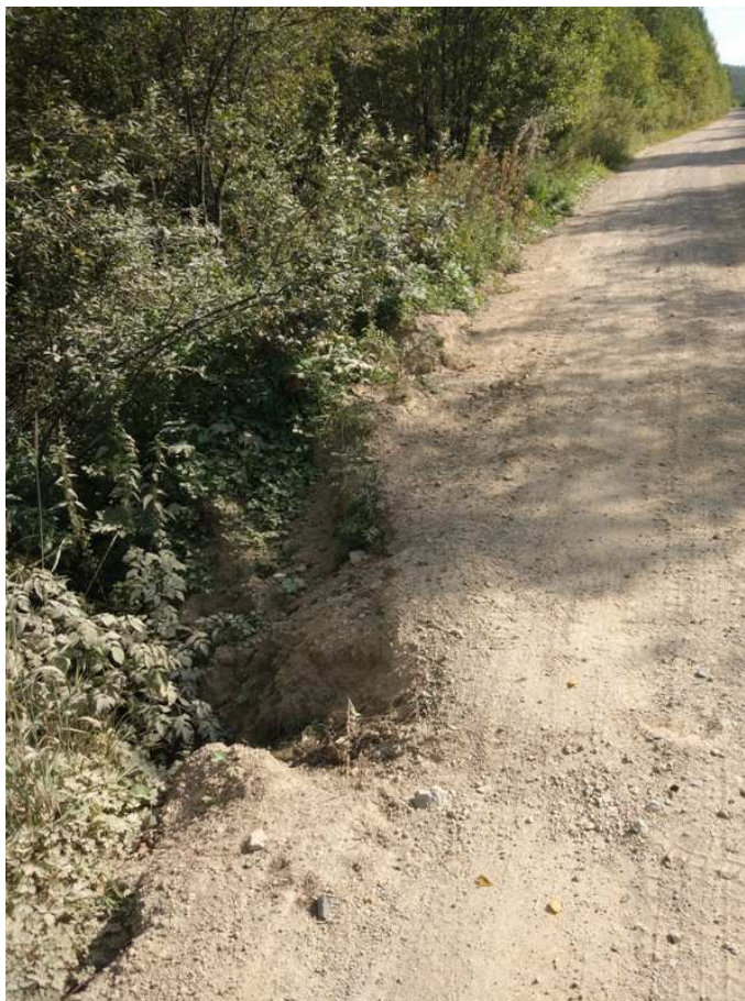
Фото – 30 а/д «Красновишерск – Вая» - Вишерогорск, км 2+230. Разрушение земляного полотна слева.
