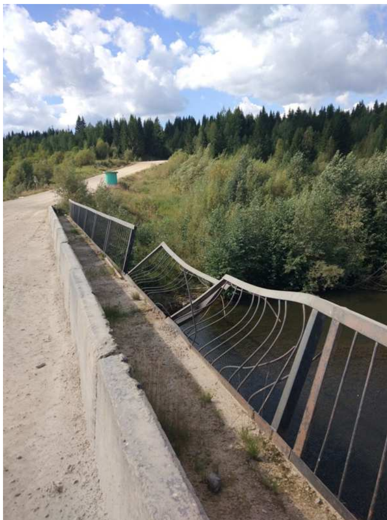
Фото 3 – а/д «Красновишерск – Вая», км 40+750, р.Большой Щугор. Требуется ремонт пешеходного ограждения на мосту.
