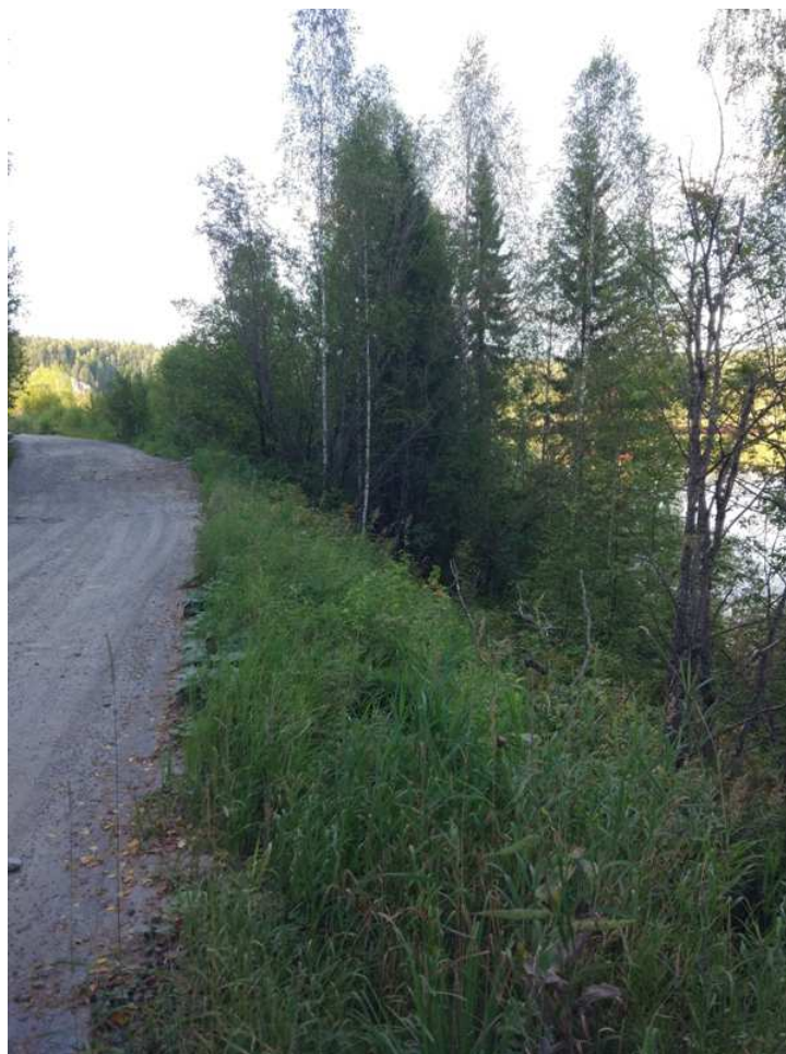
Фото 29 – а/д «Красновишерск – Вая» - Золотанка, на участке км 15+150 – 18,400 слева. Строительство ДО вдоль р. Улс
