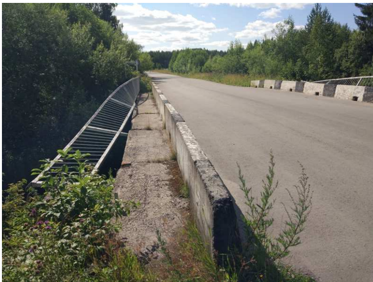
Фото 2 – а/д «Красновишерск – Антипина», км 33+500. Требуется ремонт пешеходного ограждения на мосту через р. Цепел с двух сторон
